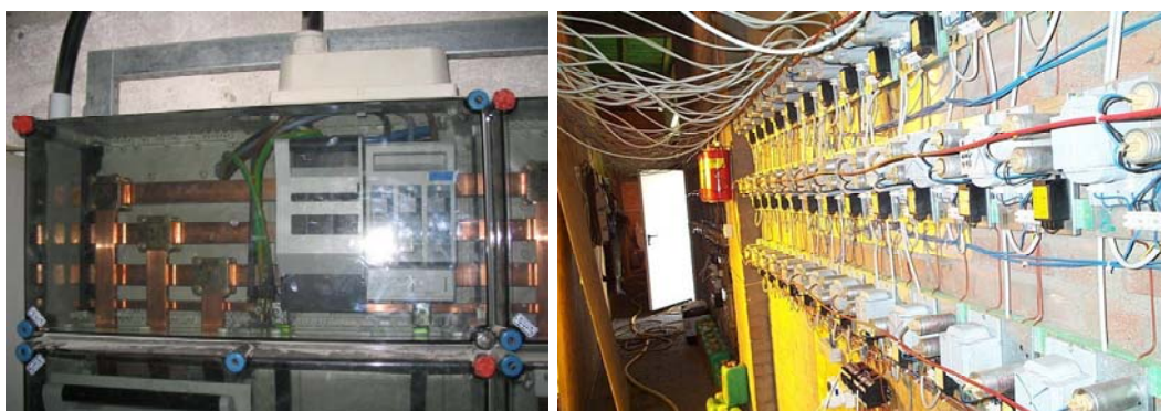
Abbildung 7: Stromabnahme und Transformatorenwand mit Feuerlöscheinrichtung
